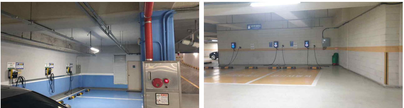
<그림 35> 화재감지기가 설치되지 않은 전기차 충전구역
