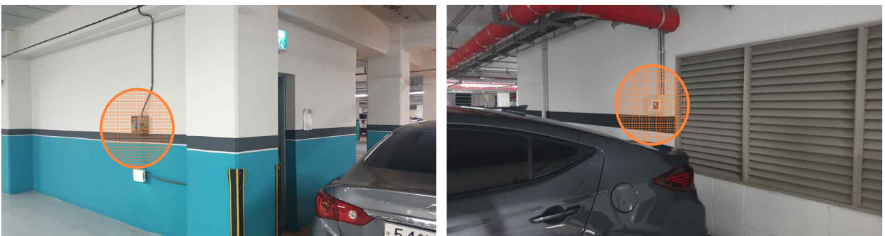
<그림 36> 출입구 근처에 설치된 수동조작스위치(좌), 차량 뒤편에 설치된 수동조작스위치(우)
