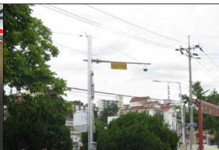
<방법용 CCTV 성능개선>
